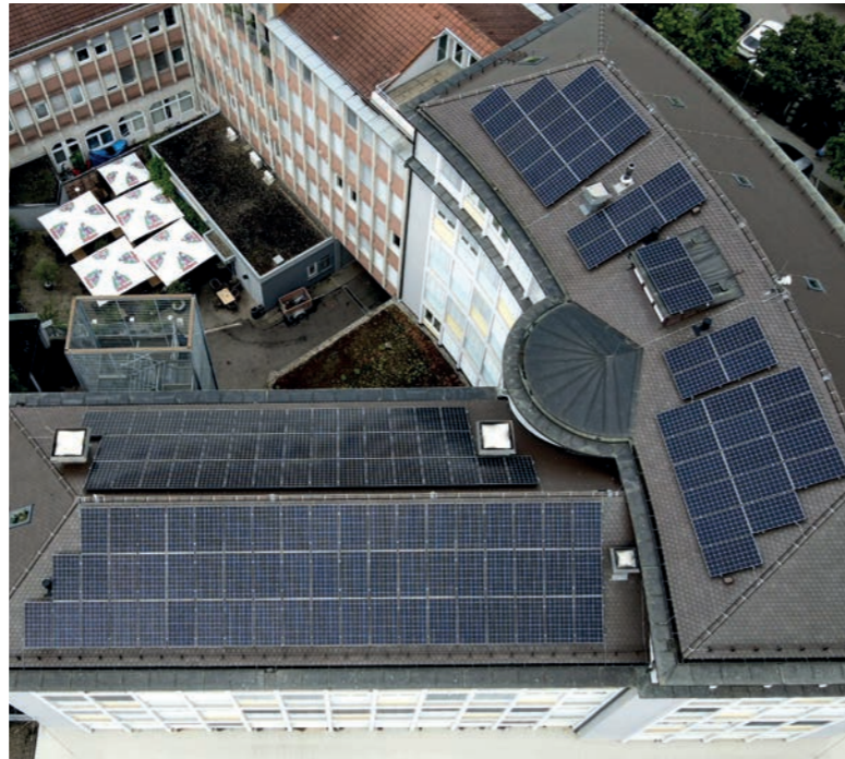
Foto: SWFR Verwaltungsgebäude mit der Photovoltaikanlage
